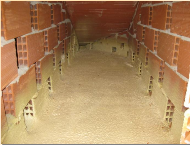
La proyección entre tabiques palomeros se adapta a todos los rincones minimizando los puentes térmicos
