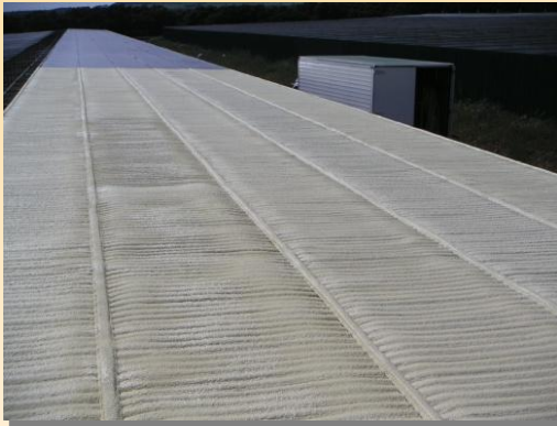
Cubierta de chapa aislada por el exterior, antes de aplicar la protección de la espuma
