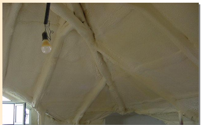
Con el poliuretano proyectado se eliminan fácilmente los puentes térmicos, independientemente de su complejidad
