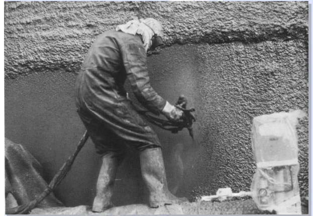
Aplicación de los años 70 de una capa de espuma de poliuretano a un depósito de almacenamiento de petróleo, para que actúe como aislante.
