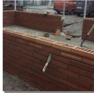
Detalle de las llagas verticales sin mortero.
