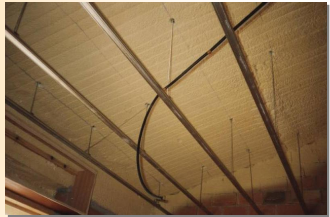
Es importante no dañar la espuma al colocar los soportes del techo.
