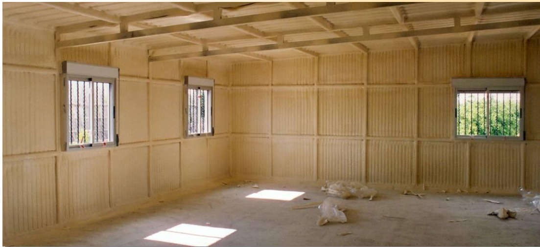
Proyectar poliuretano por el interior es la solución constructiva más apropiada cuando se quiera hacer una rehabilitación integral del edificio.
