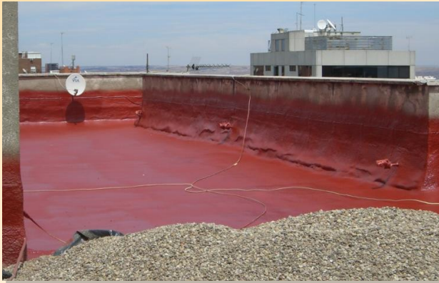
Ejemplo de cubierta no transitable protegida con elastómero y acabado de grava
