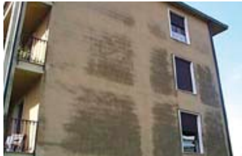
Figura 2. Edificio con defectos en los pilares y frentes de forjado
