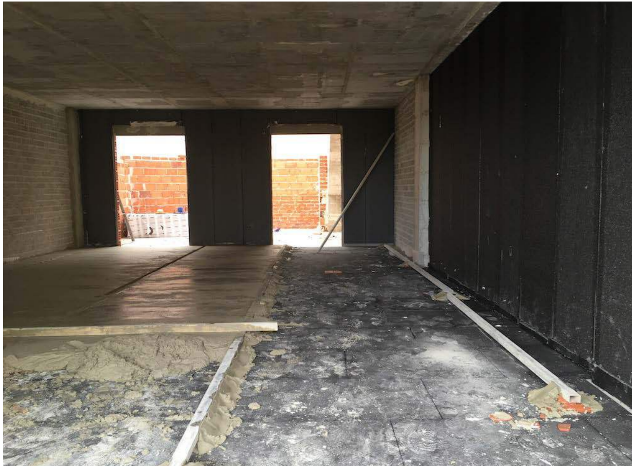
Fig. 16. Instalación de plantas de poliestireno expandido elastificado EPS T en un suelo flotante
